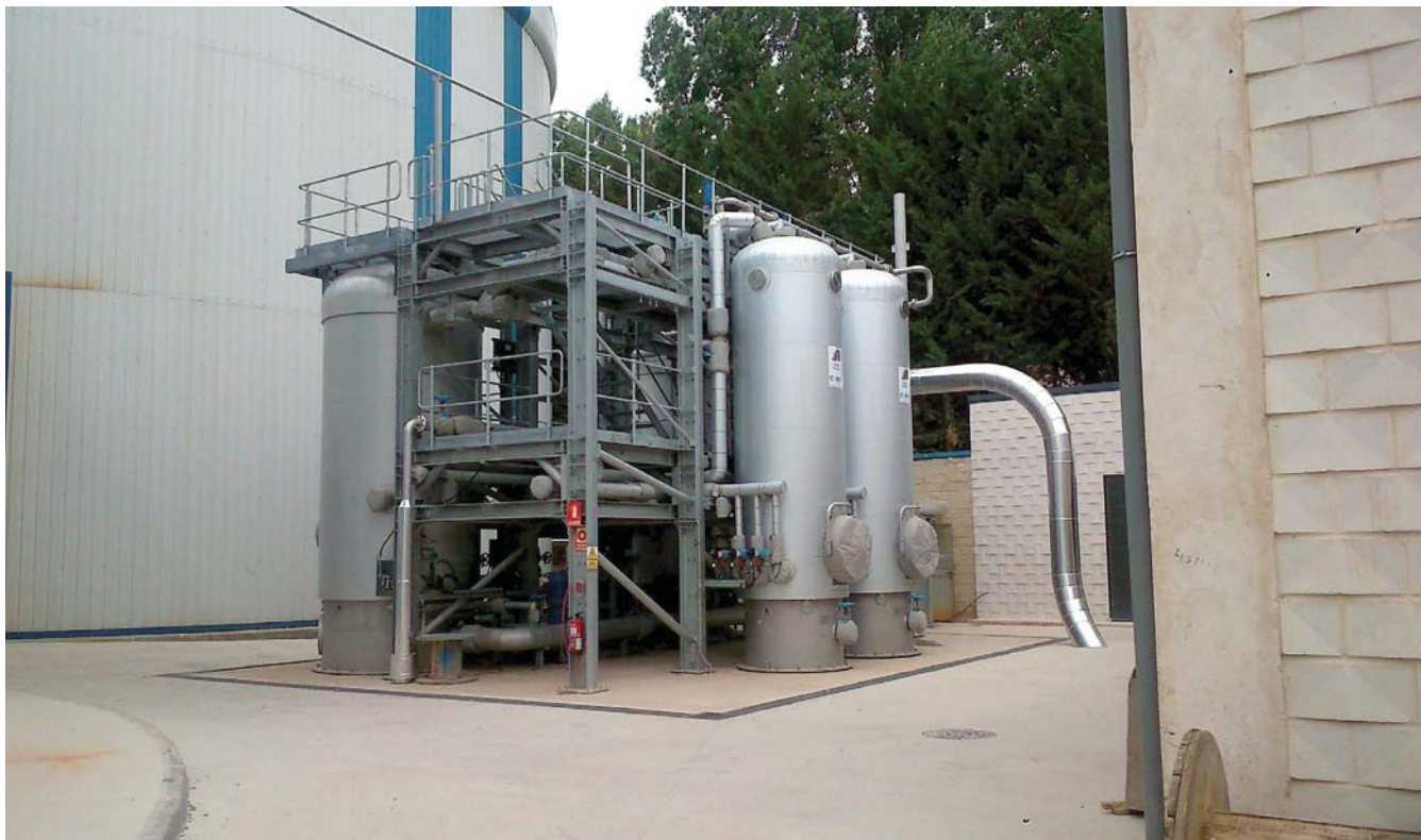
Planta de hidrólisis térmica Cambi THP B6.2 de la EDAR de Burgos. Foto facilitada por el autor del artículo.
